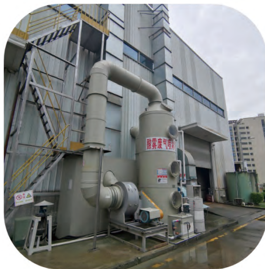
深圳廠房增設的除酸霧鹼洗塔
