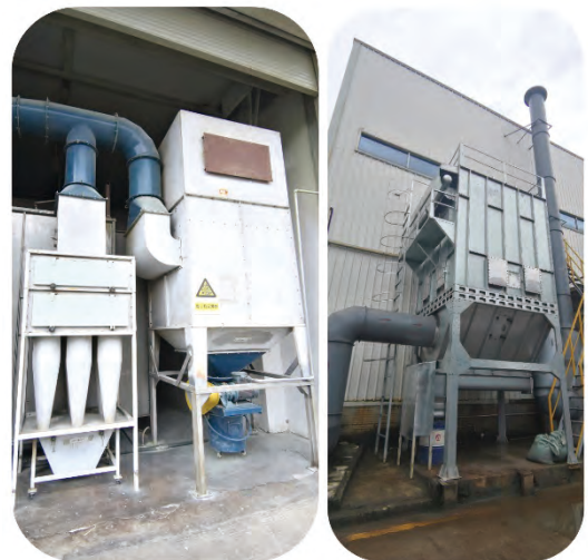
噴粉噴漆廢氣處理設備
